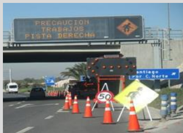
Segregación por trabajos en la vía
