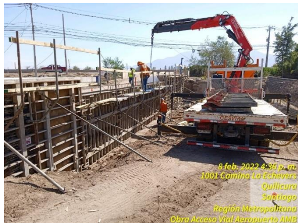
Colocación de moldaje en muro de puente alcantarilla sobre Canal del Pueblo de Quilicura
