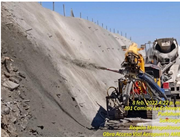
Aplicación de shotcrete para reforzar talud de relleno con presencia de basura
