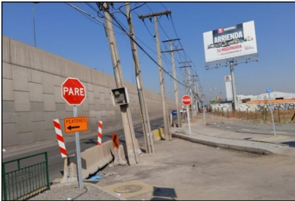
Postes de ENEL aún energizados en Ramal 2
