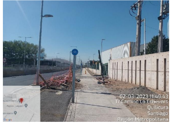
Camino Lo Boza, zona entre Km 420 – Km 360 presentaba acopio de escombros de escasa magnitud.
