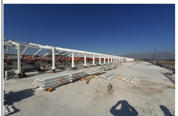
Montaje de la estructura de lucarnas en el nivel de la cubierta, en T1M
