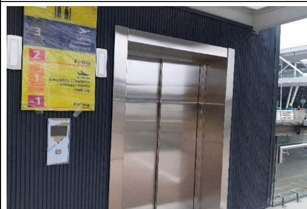
ESO: levantamiento de observaciones realizadas en pruebas SAT de Ascensores
