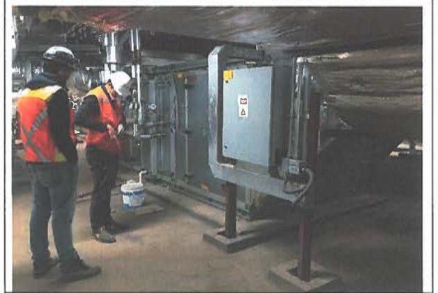
Conector BD: Nivel 2: Medición de caudales de aire en UMAS N° 27 y N° 28
