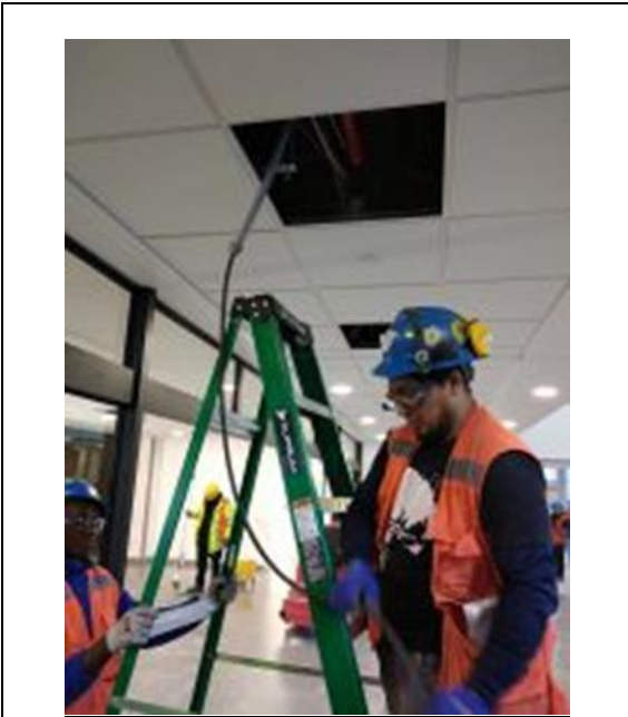
Revisión Arranque circuito fuerza, Nivel 1 de T1M Centro.
