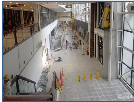
5-9-2023, Sector Hall central de T1M. Vista general de Hall central de T1M, instalación de porcelanatos, barandas vidriadas e instalación de mamparas de futuras salidas de pasajeros de vuelos domésticos.
