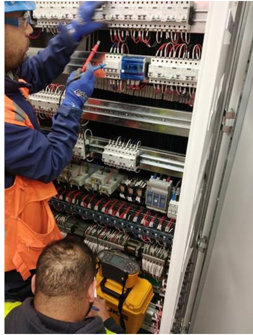
Prueba de Diferenciales de Alumbrado en TDayF, 1T1MLT015, Nivel 1 de T1M Centro.
