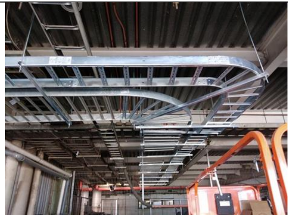
Canalización EPC exterior, PBB 17 y EX PDI, Nivel 1 de T1M Poniente.
