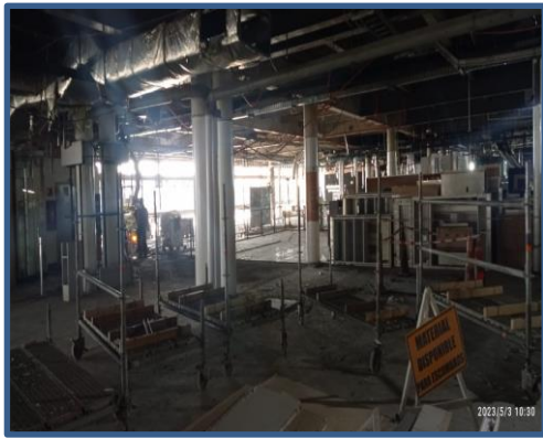
Primer Nivel. Condición de desorden en relación a acopio de escombros, se solicita mejorar condición del área indicada.
