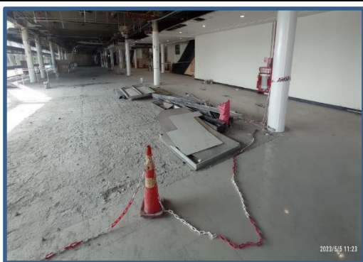
Primer Nivel Se solicita mejora de condición de orden y retiro de materiales segregados en el área.
