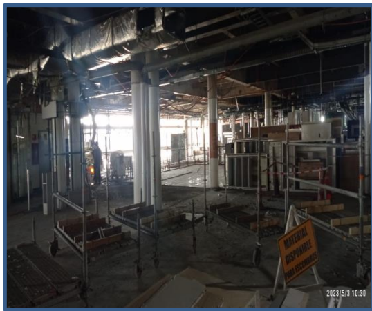
03/05/2023, Primer Nivel. Condición de desorden en relación a acopio de escombros, se solicita mejorar condición del área indicada.
