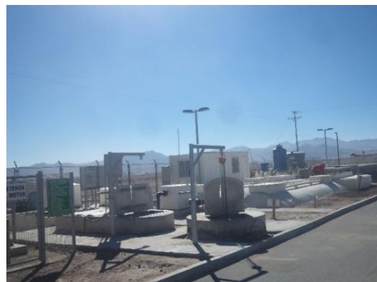
(12) Planta de Tratamiento de Aguas Servidas
