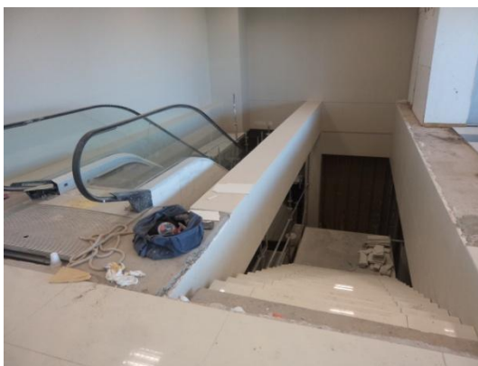
(11) Escalera Mecánica (2° Piso)
