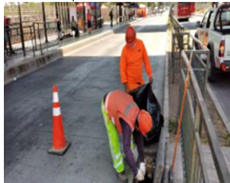
Limpieza de sumideros..
