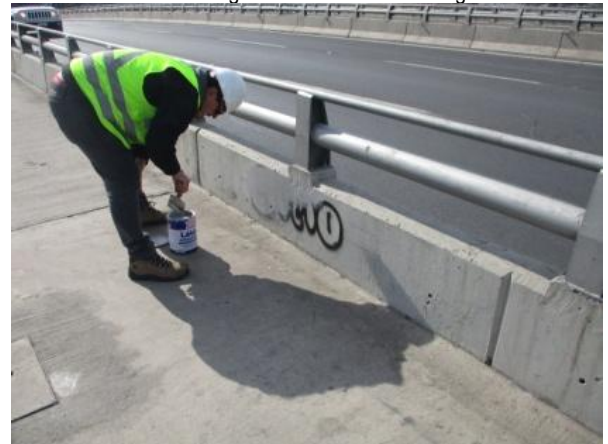
Borrado de grafiti en barrera de hormigón
