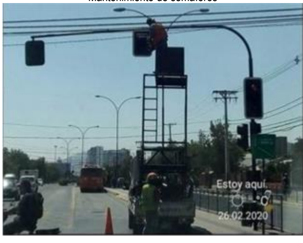
Mantenimiento de semaforos
