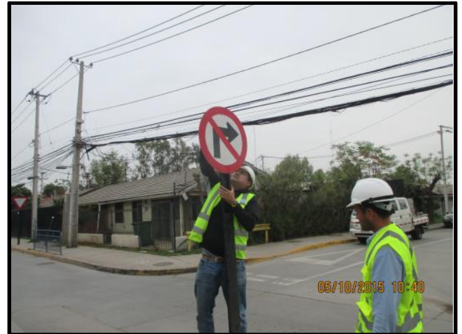
Reposición placa de señal reglamentaria "No virar derecha" Av. Suiza PK 0.515, poniente.
