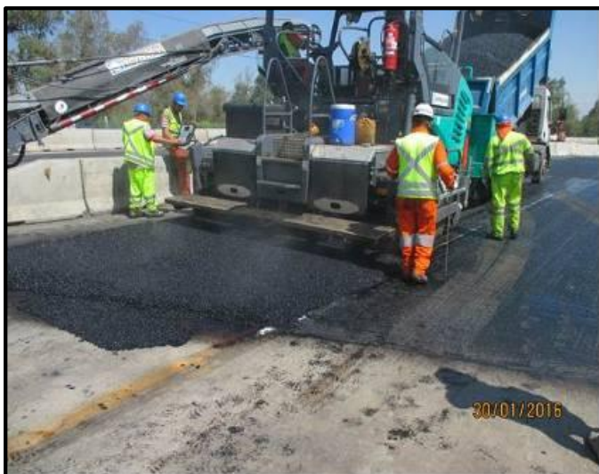
Aplicación de mezcla de Micro-aglomerado Asfáltico Discontinuo en Caliente Emeres ex vertedero Lo Errázuriz.
