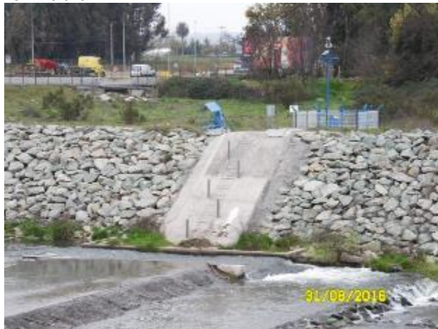
Estación de Medición T1 ruta 5
