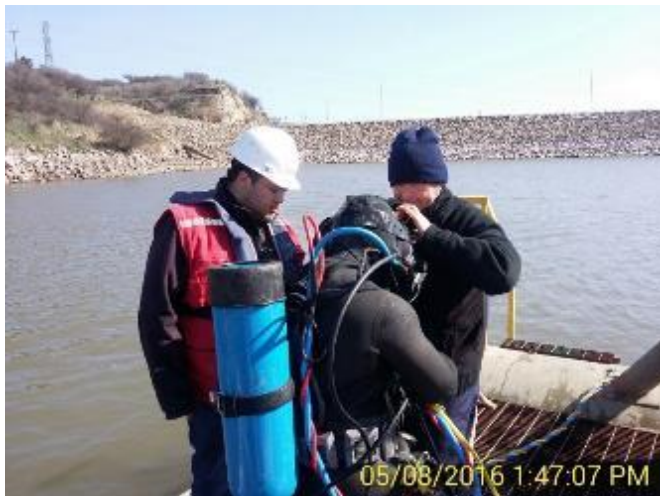
Sellado de las filtraciones del Tapón Toriesférico y Compuerta Modular por los Buzos.
