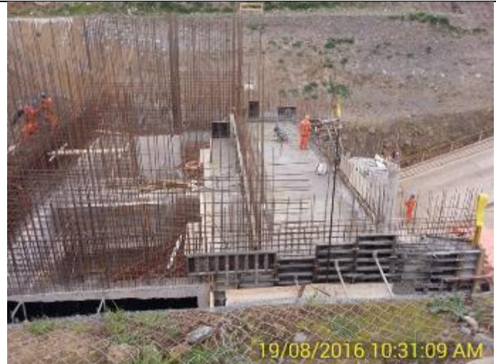
Fin de la 3ª Etapa de Hormigonado de la Casa de Máquinas terminada. 207 m 3 .
