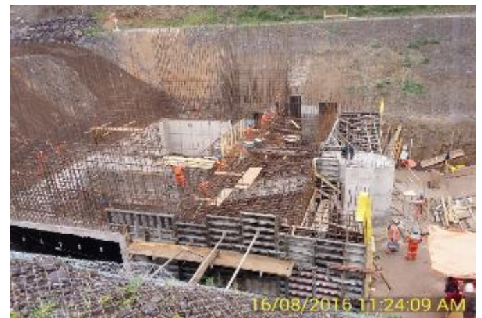
Enfierradura de la 3ª Etapa de Hormigonado. Losa y segunda parte Muros 9, 10 y 11.
