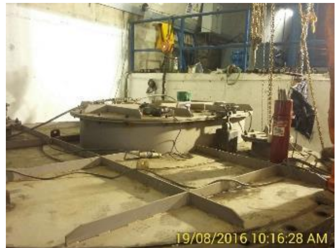
Tapa Provisoria soldada a la Brida, con mas perforaciones para pernos y Cierre Rápido instalado.
