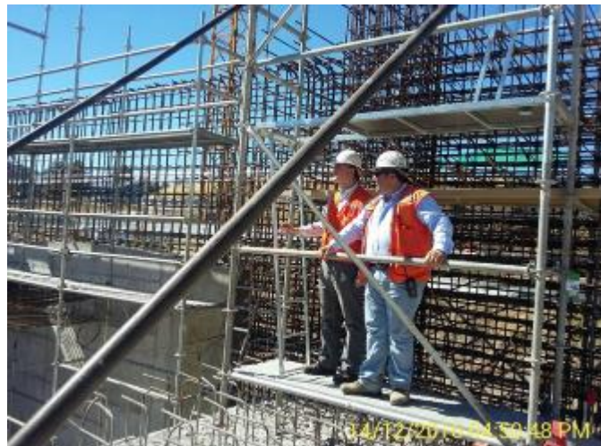
El Sr. Marcelo Beratto R. IFE del MOP y el Sr. René Valenzuela Ch. Jefe de Obras de la CHCV, recorren la Casa de Máquinas. Posteriormente visitan el Túnel Sur.
