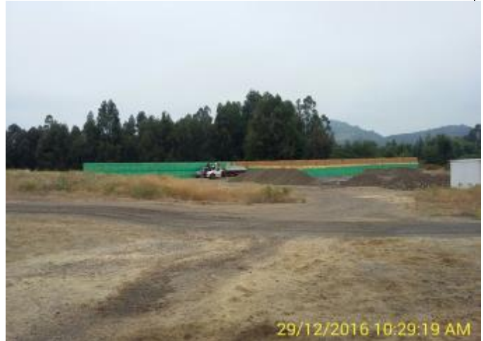
Pantalla Acústica de 100 m de largo. Se observa material de relleno bajo 3".
