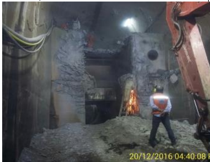
Demolición de la Superestructura de la Caverna de Válvulas del Túnel Sur, con Martillo Hidráulico. Se observa el corte de la enfierradura del hormigón armado de la Superestructura.
