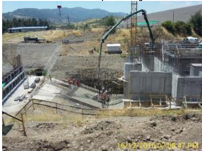
Hormigonado de la Losa Radier Inclinado Canal de Descarga lado norte. Son 189 m 3 de H30. 7ª Etapa Hormigonado.
