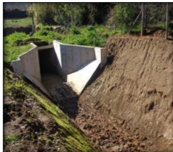
Cámara de salida de Sifón Fortaleza.
