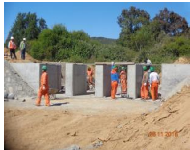
Quebrada La Vieja Insertos para Compuertas, Km 45,300
