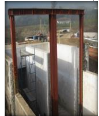
Insertos metálicos para compuertas.
