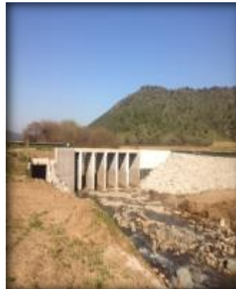
Bocatoma Canal Norte Unificado, barrera frontal.
