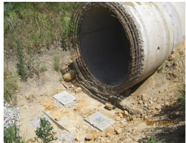
Instalación placas de apoyo, unión tubo prefabricado a pieza especial (cuello cisne), Km. 0,140.
