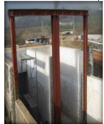
Insertos metálicos para compuertas.
