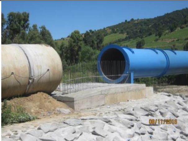
Enfierradura y hormigonado sobrelosa estribo de salida, unión paso aéreo sobre Estero Nerquihue a tubo prefabricado.
