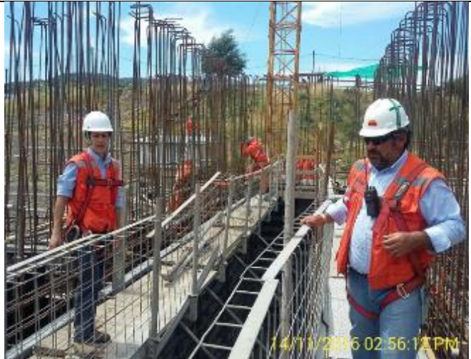
Recepción del Moldaje y la Enfierradura de los muros 21, 25, 29 y 30, con el Sr. Mario Sailer L. Ingeniero Calculista de la SC. Douglas Greig P. Inspector Jefe y Revisor de la Central y el Sr. Carlos Ramírez H. Supervisor OOC de la CHCV. 1ª Elevación, 5ª Etapa de Hormigonado.
