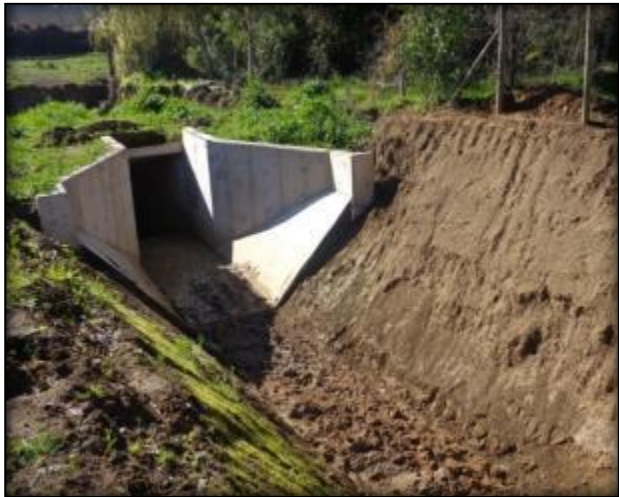
Cámara de salida de Sifón Fortaleza.
