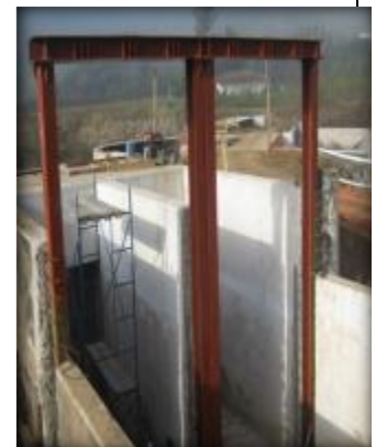
Insertos metálicos para compuertas.
