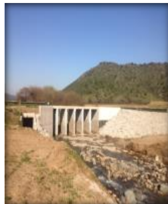
Bocatoma Canal Norte Unificado, barrera frontal.
