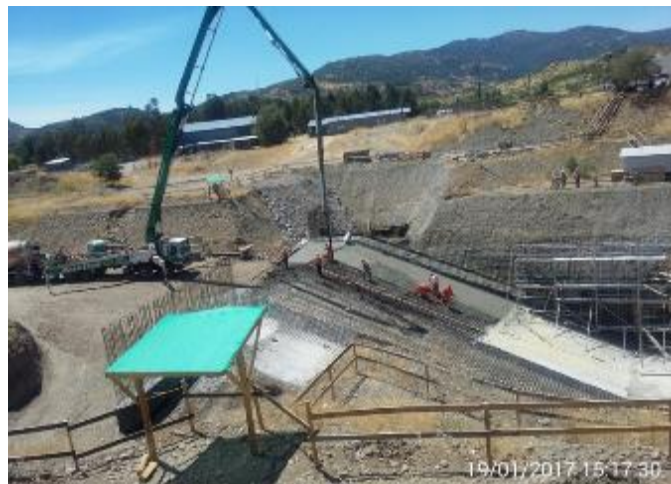
Hormigonado Canal de Descarga Casa de Máquinas, lado norponiente. 7ª Etapa de Hormigonado. Son 180 m 3 de H30.
