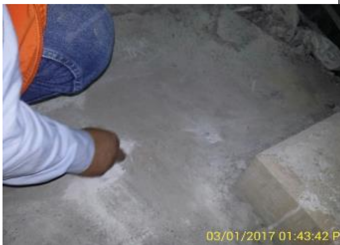
Grietas producto de la aplicación del Mortero Expansivo en las perforaciones, parte superior de la Cámara de Válvulas.
