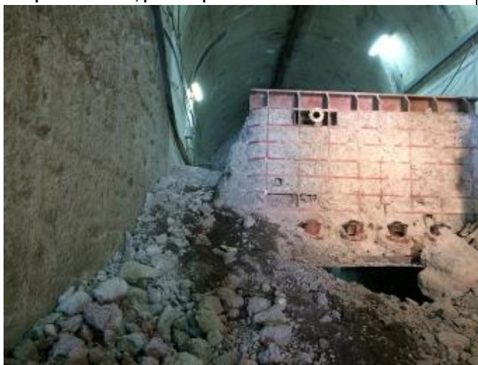
Demolición de la Superestructura de la Caverna de Válvulas del Túnel Sur, con Martillo Hidráulico montado en excavadora Link Belt 210. Trabajo en el retiro de la Guía de la Compuerta Bureau.
