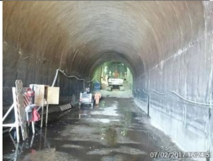
Demolición de la Superestructura de la Cámara de Válvulas del Túnel Sur con Martillo Hidráulico montado sobre la Excavadora Link Belt 210.
