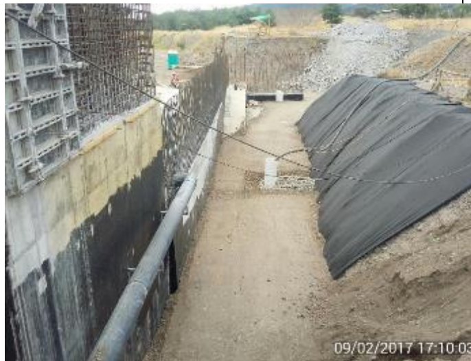
Relleno y Dren lado norte Casa de Máquinas. Se aprecia la cañería de HDPE de drenaje de los Pantalones y el Geotextil.
