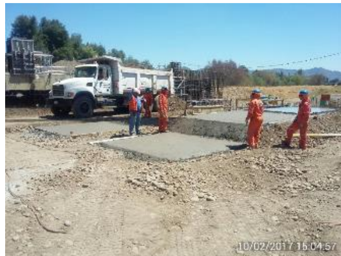
Emplantillado fundaciones F1 y F2, Plataforma lado Norte. 6ª Etapa Hormigonado Casa de Máquinas.
