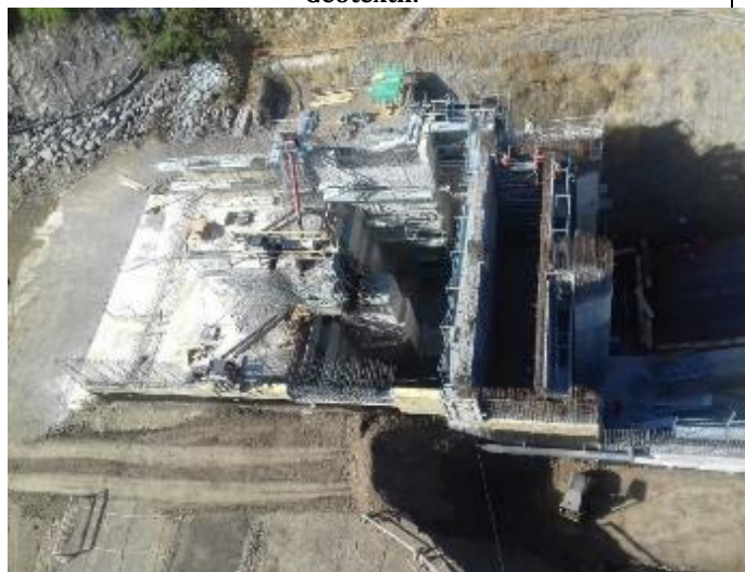
Vista aérea de la Casa de Máquinas de la Central en construcción.
