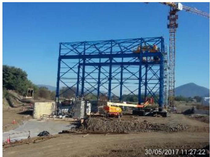
Vista General del avance de la Superestructura de la Casa de Máquinas de la CHCV.
