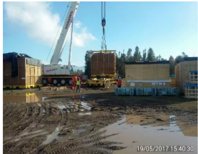
Descarga del 2º Generador de la Central, con la grúa marca Liebherr de 400 Ton, armada para 200 Ton.
