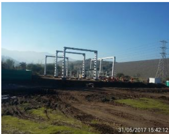
Vista general de la Subestación Seleccionadora. Se aprecian los Pórticos o Portales y los Pilares de Equipos.
