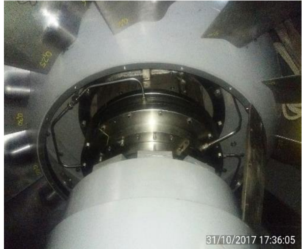
Vista interior de Turbina.
