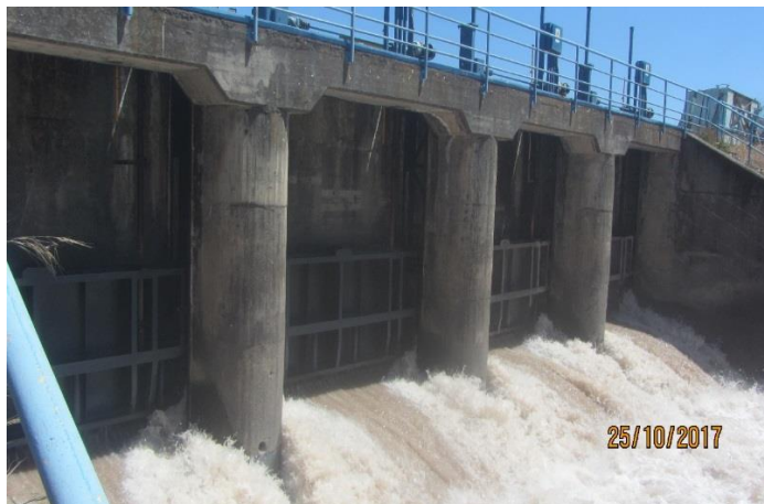
Bocatoma Canal Teno-Chimbarongo
