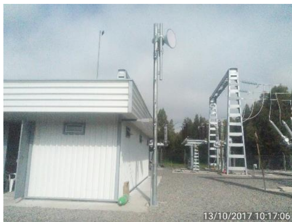
Antena de Microondas de la Subestación.
