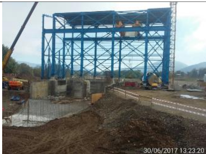
Estado de avance de la Superestructura de la Casa de Máquinas. Se aprecia la Turbina U2 descargada con el Puente Grúa en el Patio de Maniobras de la Casa de Máquinas.
