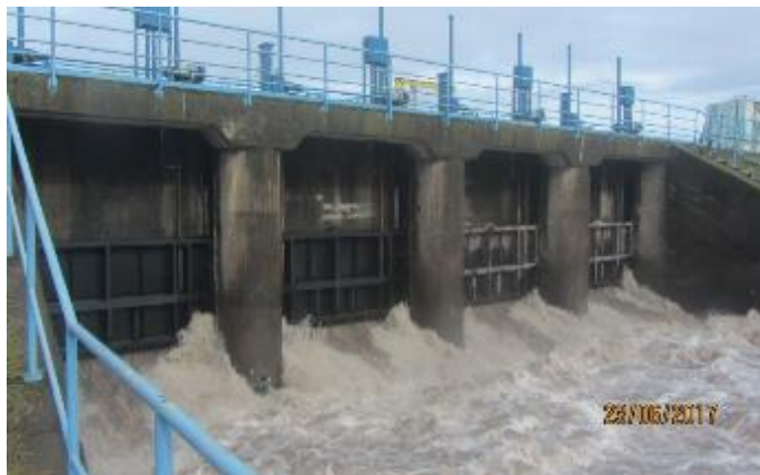
Bocatoma Canal Teno-Chimbarongo
