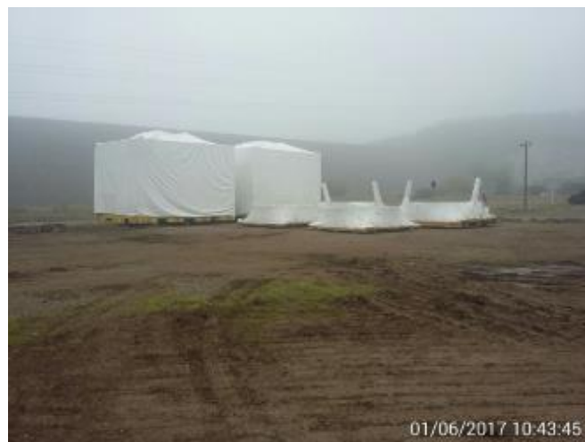
Vista General de los dos Generadores Sincrónicos y las dos Válvulas tipo Mariposa de la Bifurcación de la CHCV.
