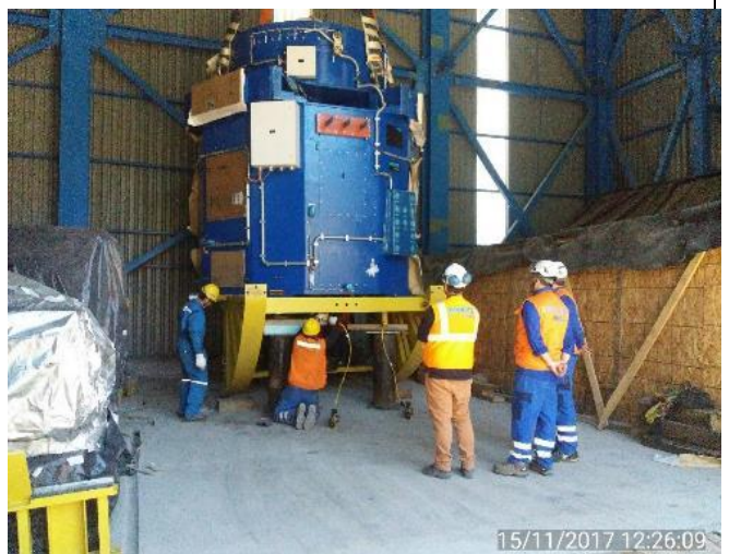
Generador N° 2 posicionado en posición vertical con el Puente Grúa Konecranes 80/10 Ton.
