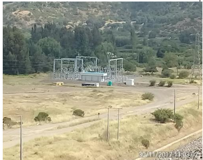
Vista general Subestación al 30 de noviembre de 2017.
