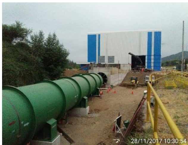
28/11/2017 10:30:54 Módulos de la Tubería en Presión en proceso de Emplastillado y de Soldadura, al 28 de noviembre de 2017.
