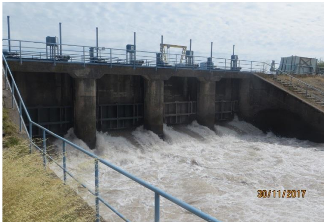
Bocatoma Canal Teno-Chimbarongo
