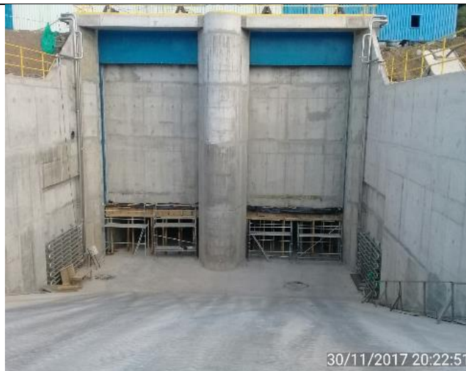
30/11/2017 20:22:51 Compuertas Planas posicionadas sobre las guías de Compuertas de la Casa de Máquinas.
