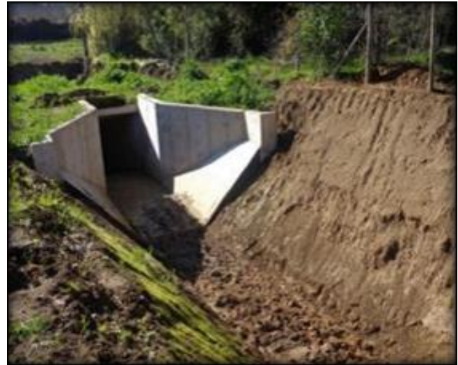
Cámara de salida de Sifón Fortaleza
