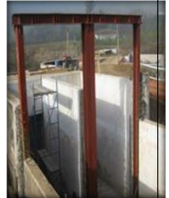
Insertos metálicos para compuertas.
