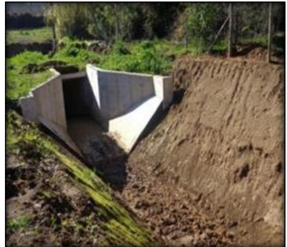
Cámara de salida de Sifón Fortaleza.
