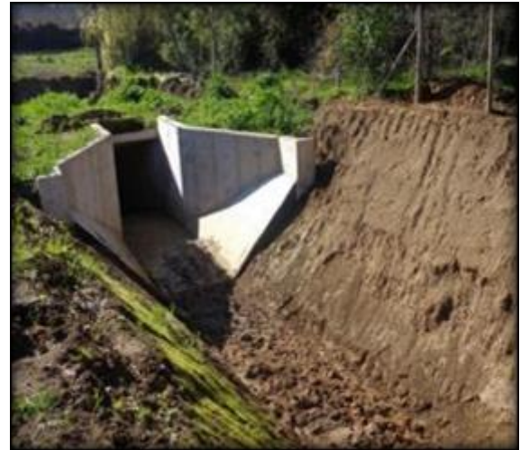
Cámara de salida de Sifón Fortaleza.
