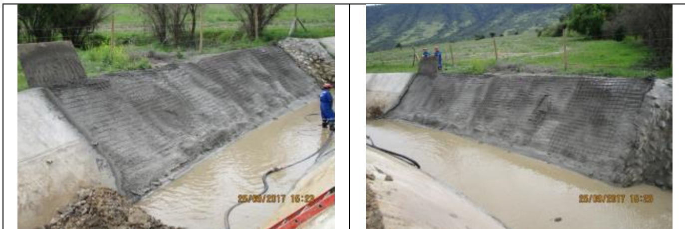
Trabajos de reparación en el Canal Norte Unificado, talud y revestimiento (Km 8,240 - Km 8,280).
