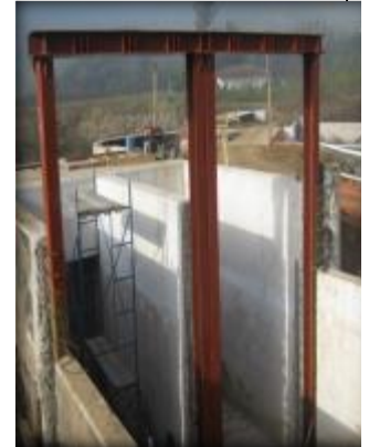
Insertos metálicos para compuertas.
