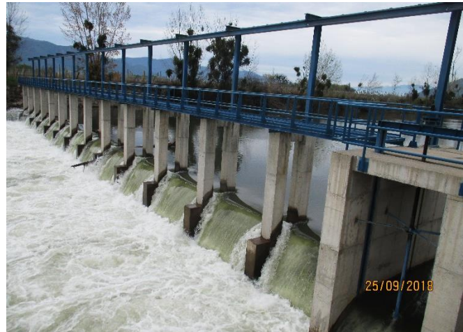
Canal Uva Blanca (Barrera con los 13 Stop-Logs instalados nuevamente)
