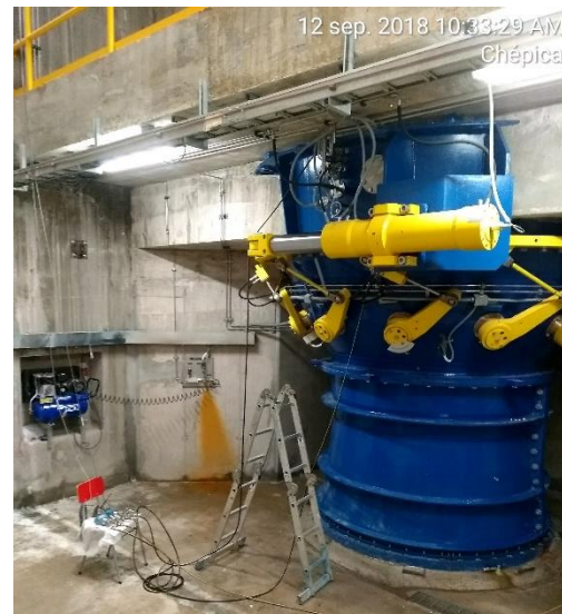
Turbina U1 interior casa de máquinas piso elevación 232.45 m.s.n.m, durante pruebas de rendimiento
