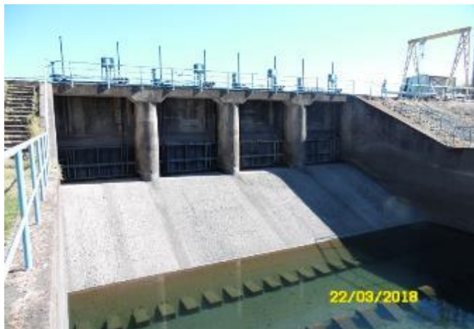
Bocatoma Canal Teno-Chimbarongo
