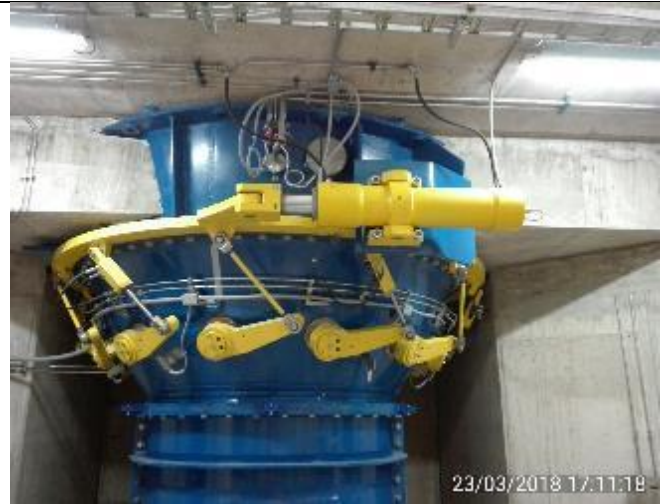
Unidad Nº 1 girando a 300 rpm, la posición del Distribuidor de la Turbina corresponde a 19.86 %.
