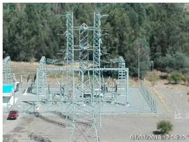
Vista General de la Subestación CHCV al 1º de marzo de 2018. Se aprecia la S/E, Torres de Traspaso y la Torre N° 140 de la Línea de 154 KV de Transelec.
