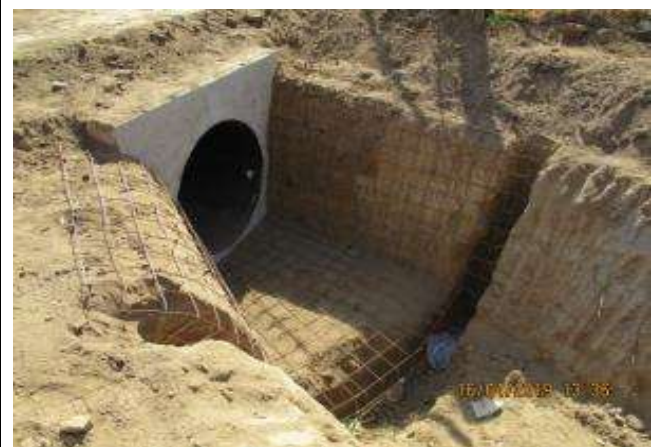
Canal El Fondo; Preparativos para proyección de hormigón de los muros de transición del cruce predial del km 1,540.
