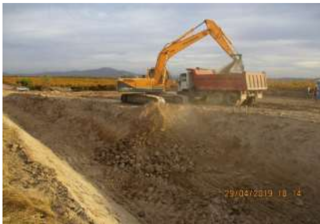
Canal El Molino; excavación masiva en sector alto km 2,0 al km 2,3. El sello de esta corresponde a la plataforma del canal
