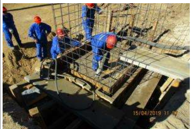
Canal El Fondo; Vaciado de hormigón cámara de entrada del Sifón del km 1,700.
