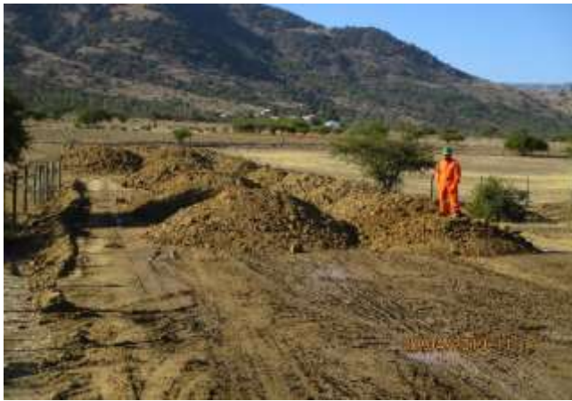
Canal El Fondo; Conformación de terraplén en sector bajo km 2,8- km3,1, para conformación de la plataforma.
