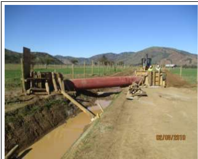
NCS; ramal El Fondo, cruce aéreo de canal (km 3,160).
