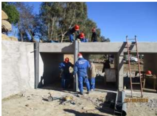
NCS; Poza Quilahue N° 1 de ramal El Fondo, instalación de guías “stop log” de barrera transparente.
