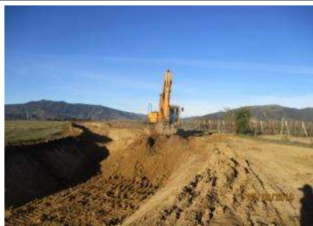
Ramal El Molino; tramo 2.1 (Km 1,400 - km 1,600), excavación para conformación de la mesa del canal, que se excavará a partir del sello de esta.
