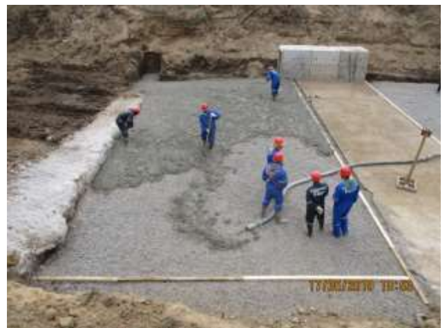
Canal El Molino; Vaciado de hormigón de emplantillados fundación de barrera y losas Oriente y Poniente
