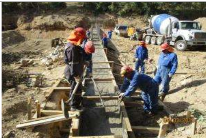
Vaciado de hormigón de 3a elevación de muro lado poniente en Poza N° 1 Quiahue.
