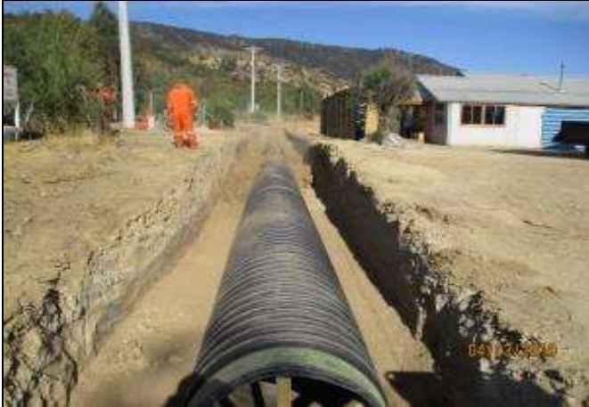
Relleno estructural sub tramo entubado del canal El Fondo con tubos HDPE D=1,2, entre el km 1,700 y el km 1,742.
