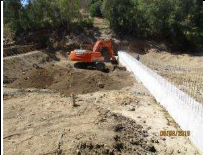
Reemplazo de material de relleno de la plataforma bajo la cortina transparente de la poza Quiahue 1.
