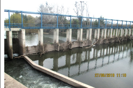
Bocatoma Uva Blanca
