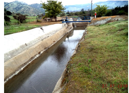
Estación Tipo 2 Quebrada Los Cardos y captación del canal Panamá.
