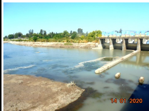
Bocatoma de Canal Tenó-Chimbarongo
