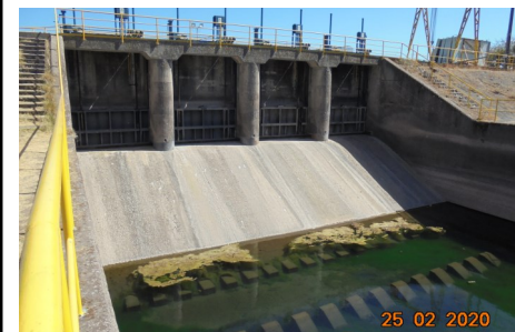
Canal Teno-Chimbarongo en Bocatoma, (compuertas de admisión)
