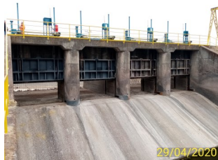
Canal Teno-Chimbarongo en bocatoma, Compuertas de admisión.
