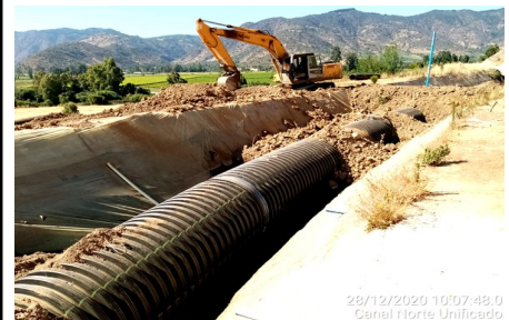
Red de canales Fase III, Canal Norte Unificado (reparación entre el Km 11,980 y 12,100).
