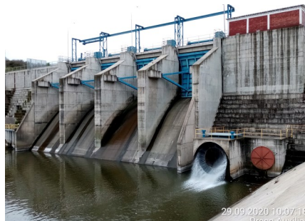
Presa Auxiliar en operación.
