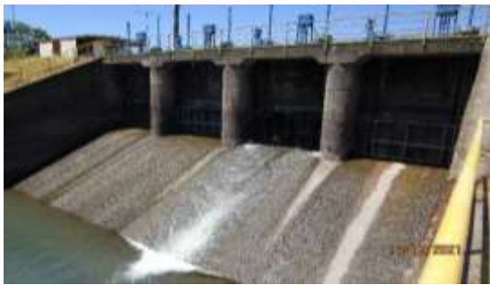
Bocatoma canal Teno-Chimbarongo.
