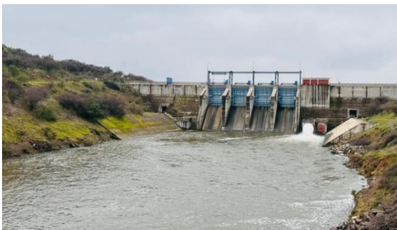
Imagen N°3. Vista general y funcionamiento de la válvula de entrega a riego Howell-Bunger.
