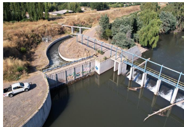
Bocatomas Las Toscas. Compuertas de admisión Canal Matriz Nilahue tramo 1 en normal funcionamiento.
